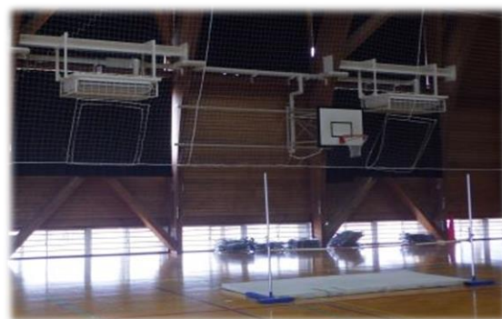
赤堀南小学校体育館 空調設備
