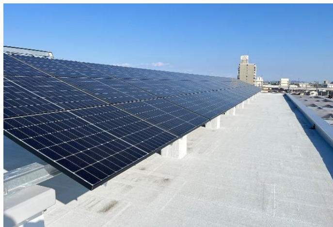
図 6-3 太陽光発電設備
