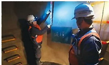
管路内の損傷箇所調査
