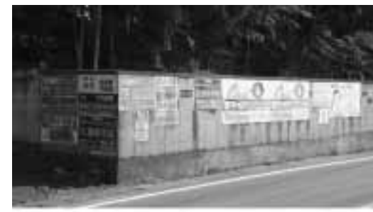
悪質な簡易広告物がはられた塀
