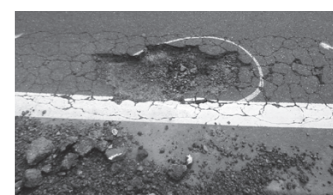
◀破損した道路
