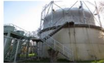
消化ガスタンク
