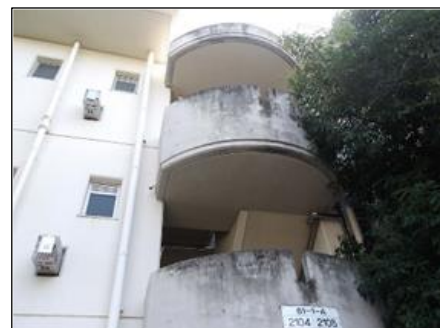
図5-3 屋上・外壁の劣化等
