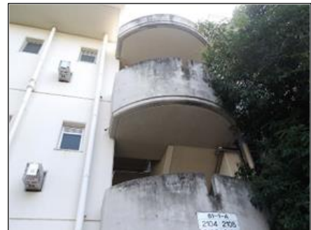
図5-3 屋上・外壁の劣化等
