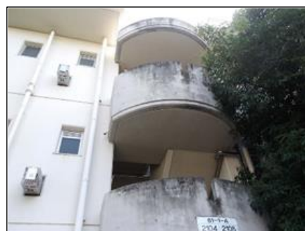
図 5-3 屋上・外壁の劣化等
