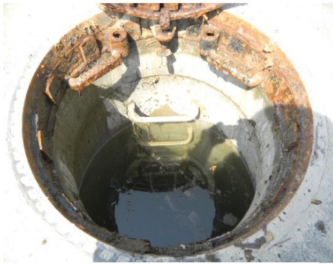
マンホール内に 汚水が溜まった例
