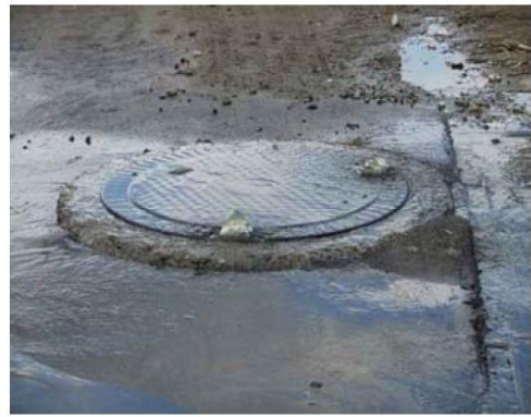
マンホールから 汚水があふれた例
