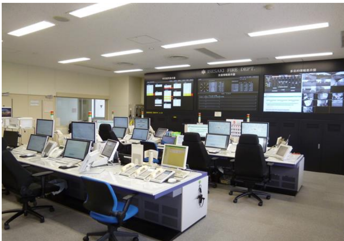
高機能消防指令センター
