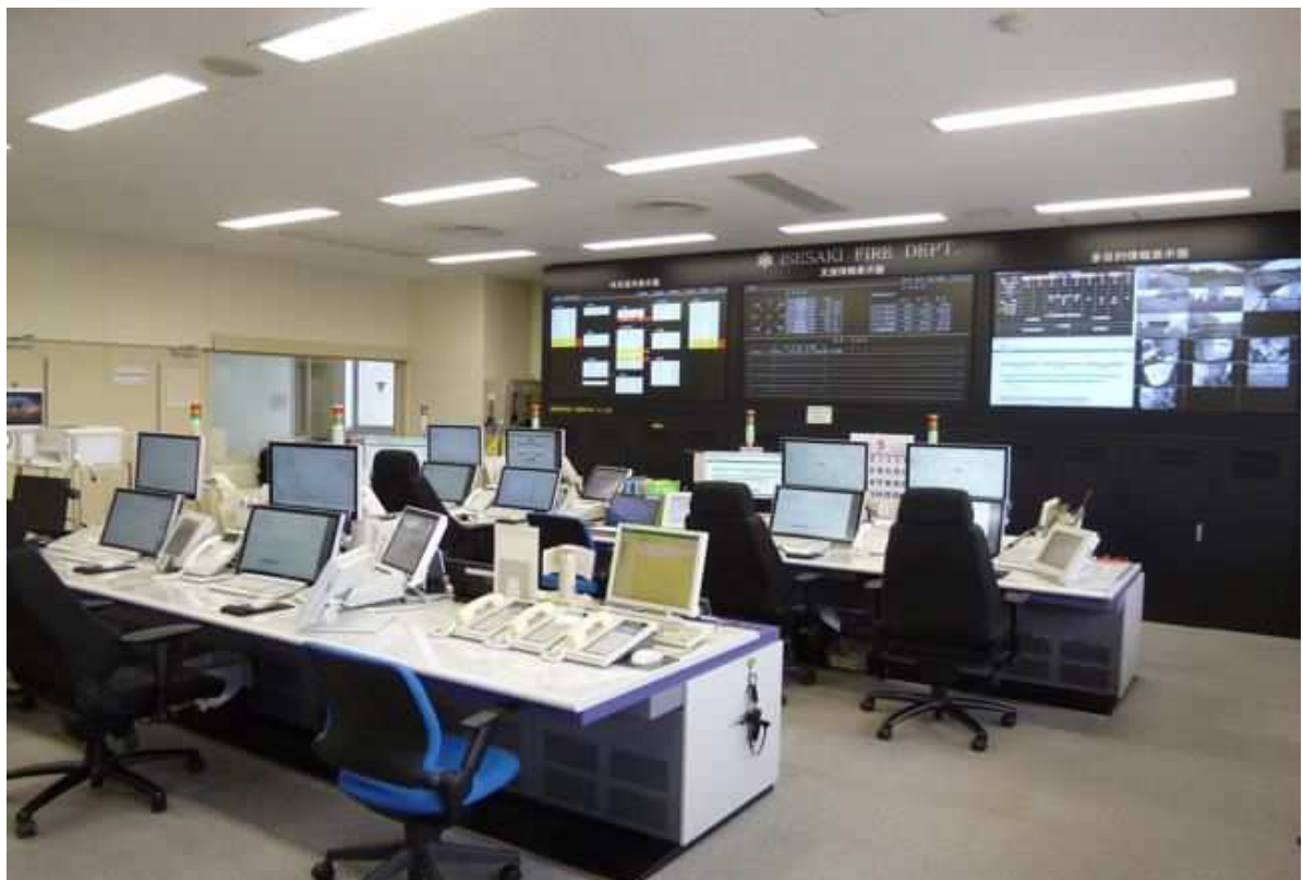
高機能消防指令センター
