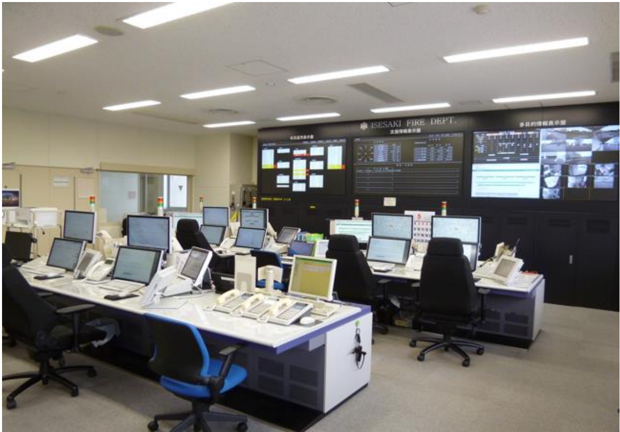
高機能消防指令センター
