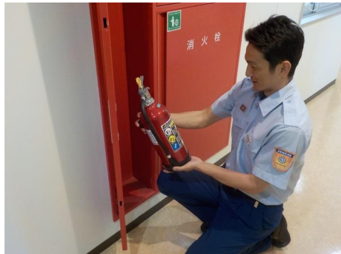
消火器具の消防検査
