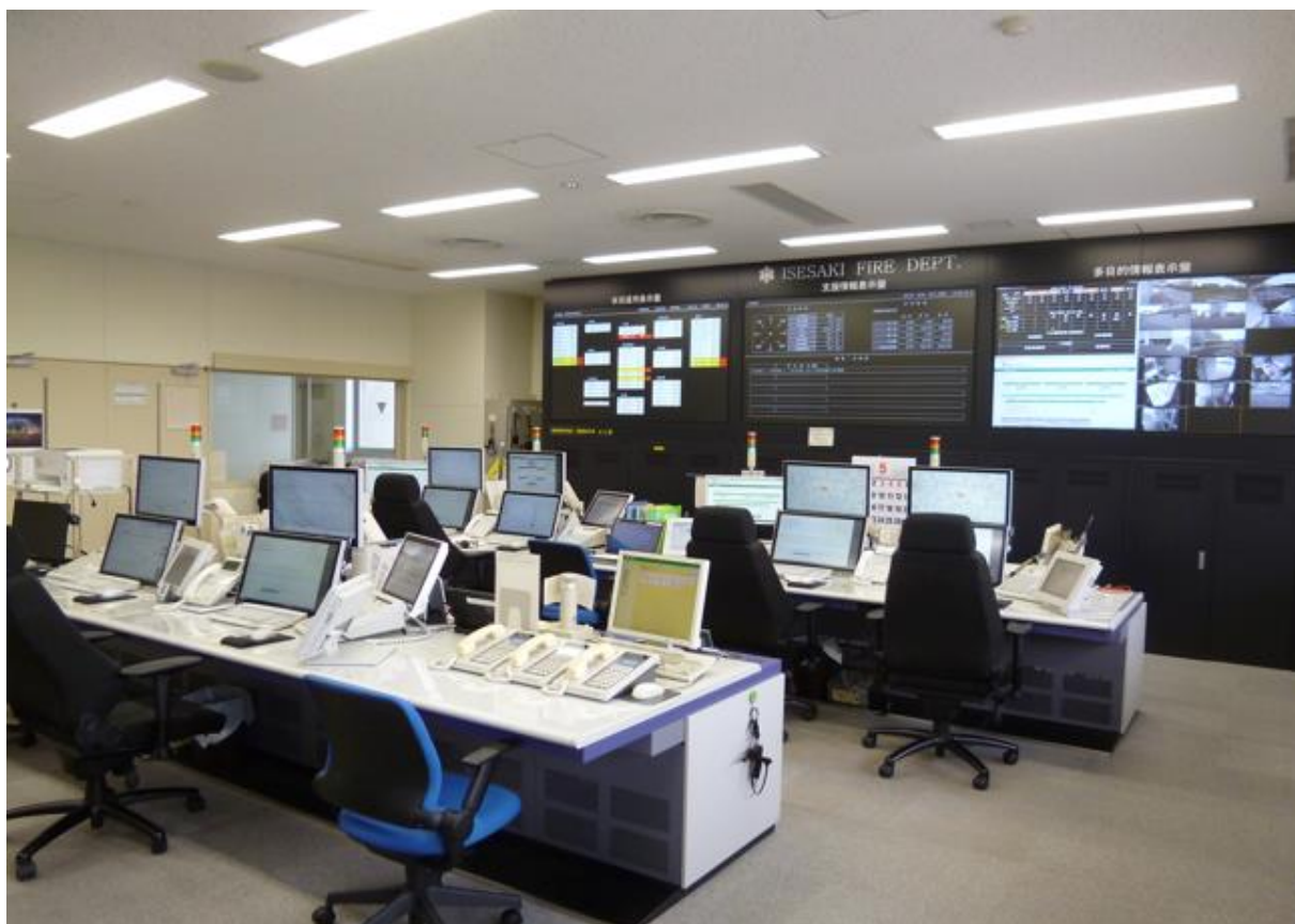
高機能消防指令センター
