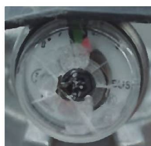
× 指示圧力計の損傷
