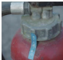
× キャップの劣化
