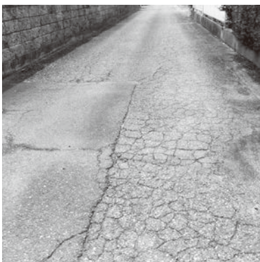
路面が傷んだ私道に補修助成を
