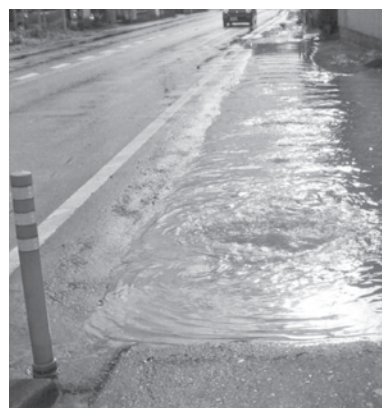
グレーチングから雨水の逆流出
