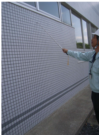
外壁タイルの浮きの調査
